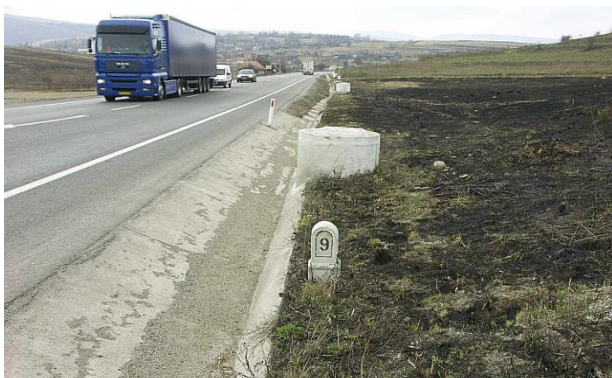
Sistem de drenaj ca obstacol pe drum
