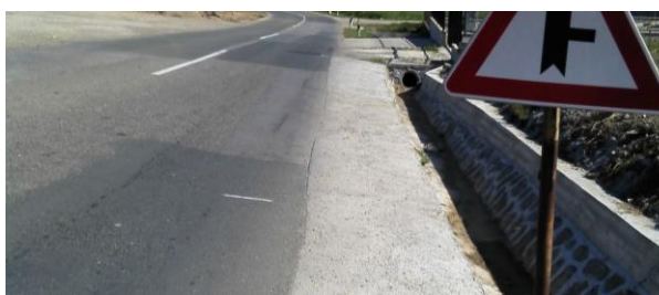
Sistem de drenaj nesigur, cu parapet din beton
