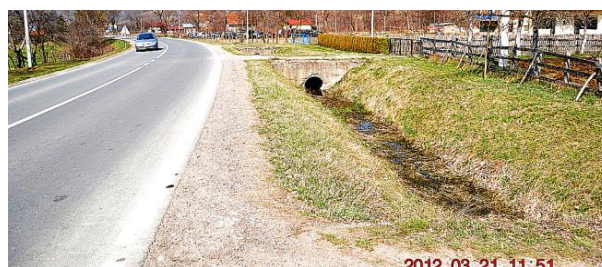
Sistem de drenaj nesigur de tip U, cu parapet din beton
