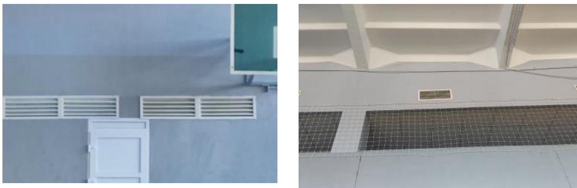
Figura 7. Vedere grile de ventilare din sala de sport
