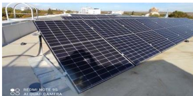
Figura 13. Vedere a panourilor fotovoltaice
