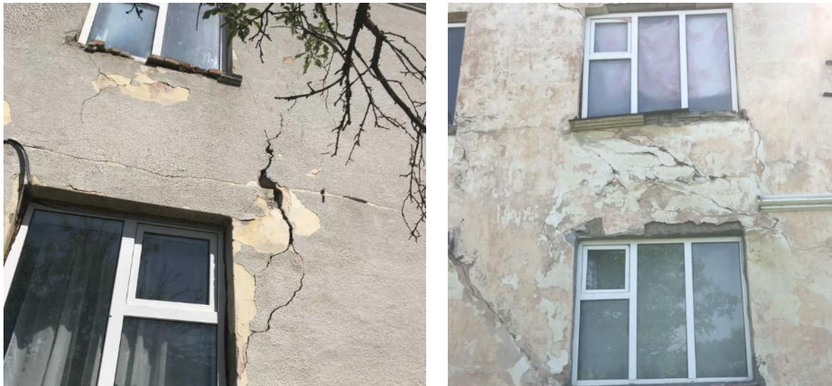
Рисунок 1. Трещины в несущей стене здания как признак неравномерных осадок фундаментов
