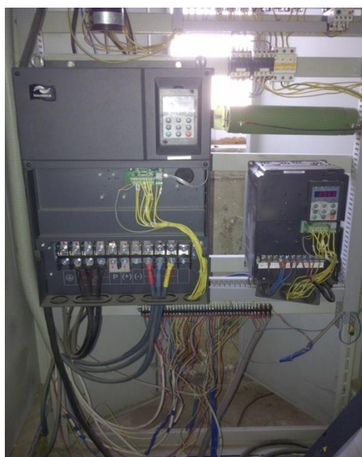
Figura 1.10. Panoul de forță cu convertoarele de frecvență a trefilorului și bobinatorului
